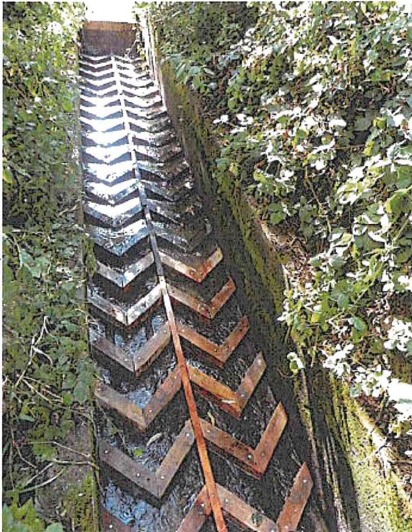
Vue de la passe à ralentisseurs installée en rive droite (photographie du 03/07/2019)
