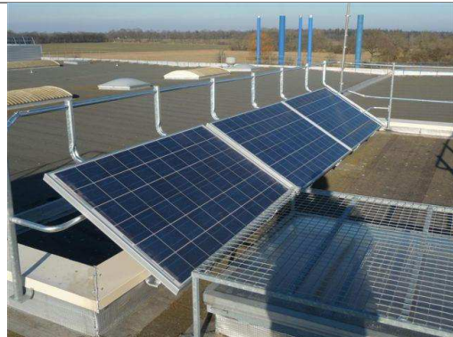
Garde-corps, inclinaison 30° vers intérieur de la terrasse
