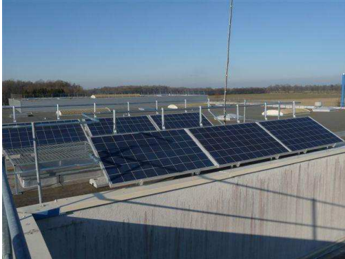
Garde-corps, inclinaison 30° vers extérieur de la terrasse
